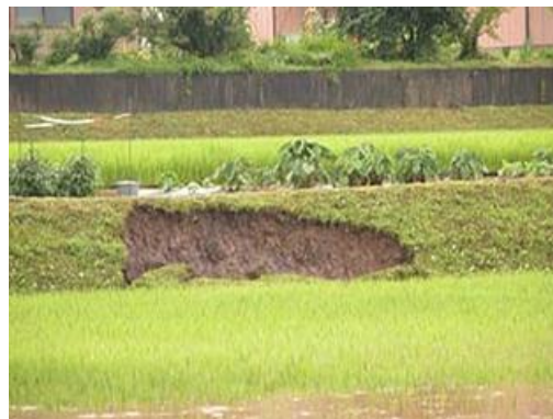
法面の崩壊状況
