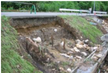
道路法面の崩壊状況
